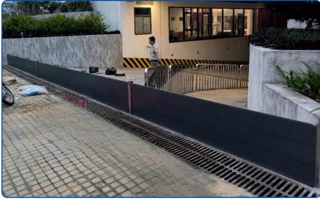
Chống ngập tầng hầm Công viên vườn tượng APEC
